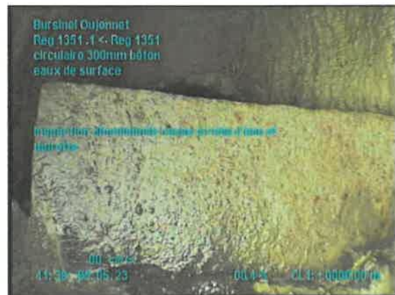
8, 00:00:36, 0.60m Inspection abandonnée / cause niveau d'eau et murette
