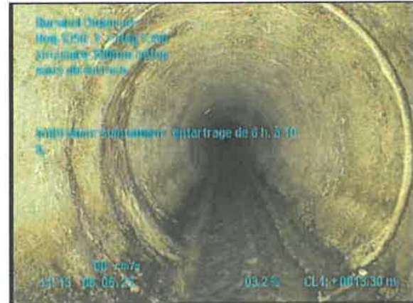
6, 00:02:33, 13.30m Infiltration: suintement / entartrage de 6 h. à 10 h.
