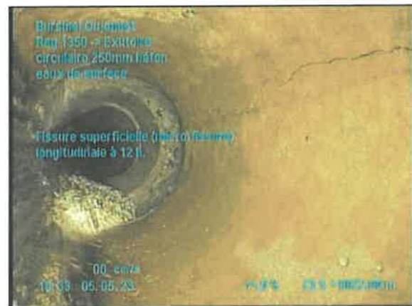
20, 00:08:07, 22.80m Fissure superficielle (micro-fissure) longitudinale à 12 h.
