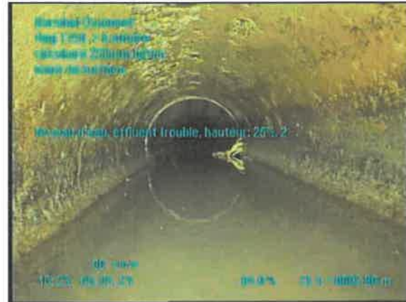
6, 00:01:17, 2.80m Niveau d'eau, effluent trouble, hauteur: 25%, 2
