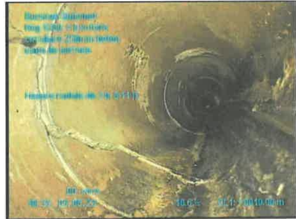
18, 00:06:55, 19.00m Fissure radiale de 3 h. à 11 h.
