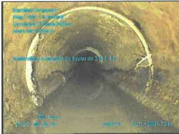
9, 00:02:30, 7.70m Radicelles, à un joint de tuyau de 3 h. à 4 h.
