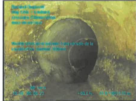
14, 00:04:04, 11.70m Modification de la section transversale de la canalisation, hauteur: 400mm
