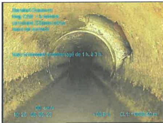
11, 00:03:01, 8.50m Raccordement endommagé de 1 h. à 3 h.
