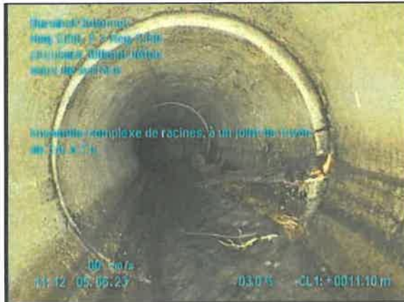
5, 00:01:59, 11.10m Ensemble complexe de racines, à un joint de tuyau de 3 h. à 7 h.
