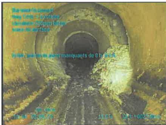
23, 00:08:46, 23.50m Éclat / partie de paroi manquants de 8 h. à 4 h.
