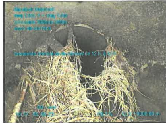
2, 00:00:04, 0.80m Ensemble complexe de racines de 12 h. à 12 h.
