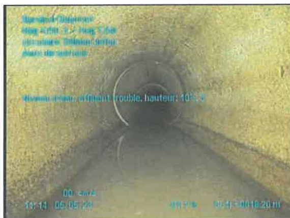
7, 00:03:13, 18.20m Niveau d'eau, effluent trouble, hauteur: 10%, 3
