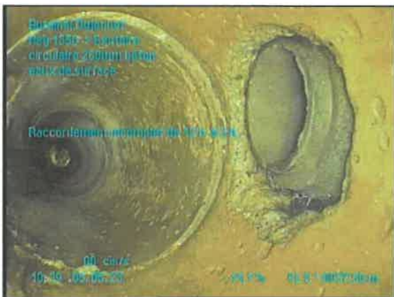
31, 00:12:12, 37.50m Raccordement incomplet de 12 h. à 3 h.
