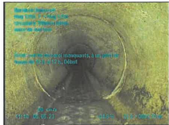
4, 00:00:35, 1.10m Éclat / partie de paroi manquants, à un joint de tuyau de 12 h. à 12 h., Début
