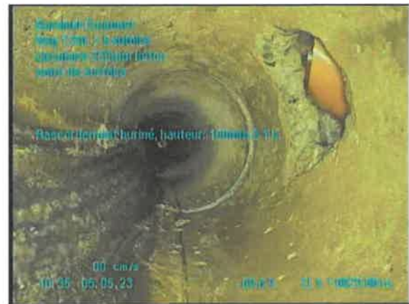
24, 00:09:38, 29.00m Raccordement buriné, hauteur: 100mm à 1 h.
