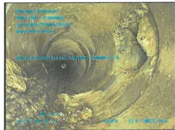
28, 00:11:01, 31.70m Raccordement buriné, hauteur: 200mm à 2 h.
