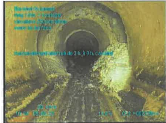
22, 00:08:42, 23.50m Raccordement obstrué de 3 h. à 9 h. / calcaire
