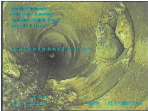
29, 00:11:06, 31.70m Raccordement endommagé de 1 h. à 3 h.
