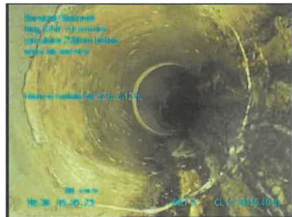
16, 00:05:40, 15.40m Fissure radiale de 12 h. à 12 h.
